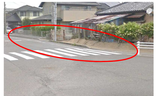
小学校入口交差点横断歩道付近にガードレール等の防護柵なし
